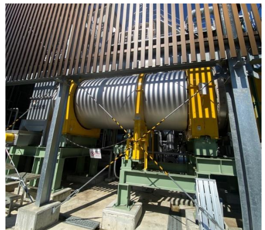
固形燃料化設備
