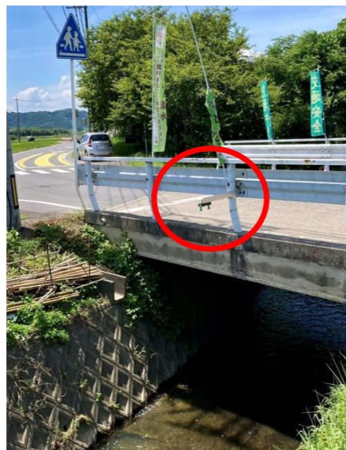
設置状況 中津井川 弓削(下別当橋)
