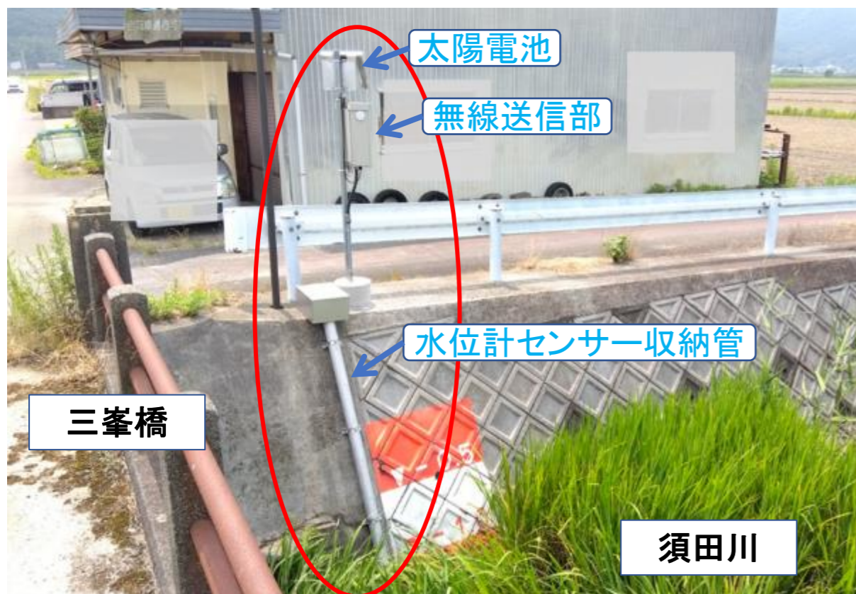
現地設置状況
