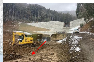
写真② 知内川支流:溪流保全工(R7.12撮影)
