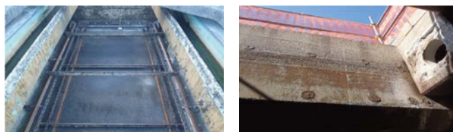
劣化が進む水処理施設
