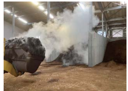
上：コンポスト化施設外観 下：発酵中の汚泥は90度近い高温で、攪拌作業により水蒸気が上がっています。
