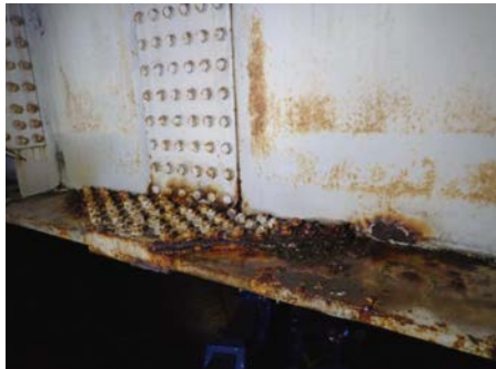
橋梁の損傷状況（主桁の劣化）
