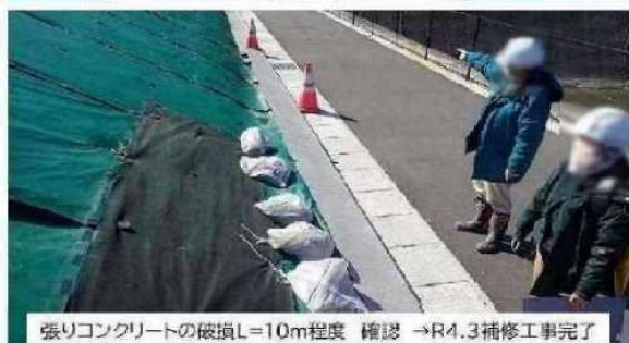
張りコンクリートの破損L=10m程度 確認 → R4.3補修工事完了
