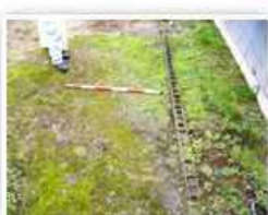
②被害状況確認（宅盤）
