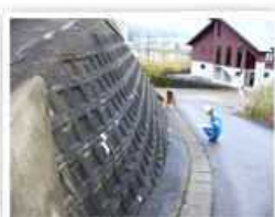
①被害状況確認（擁壁）
