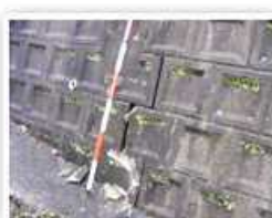
③被害状況の詳細調査
