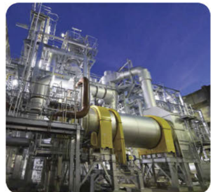
污泥燃料化施設
