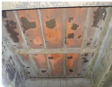
橋梁の損傷状況（防食機能の劣化）
