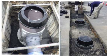
マンホールトイレ設置
