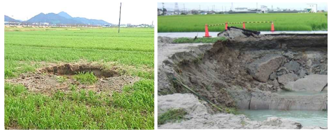
パイプラインの損壊による農地の陥没事故
