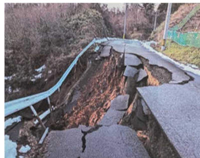
能登半島地震 道路被災状況
