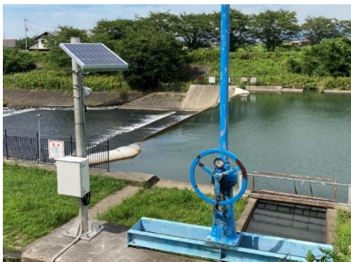
太陽光パネル付き監視カメラ
