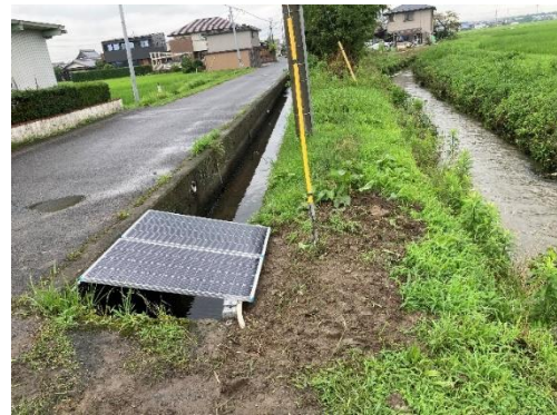
開水路の太陽光パネル
