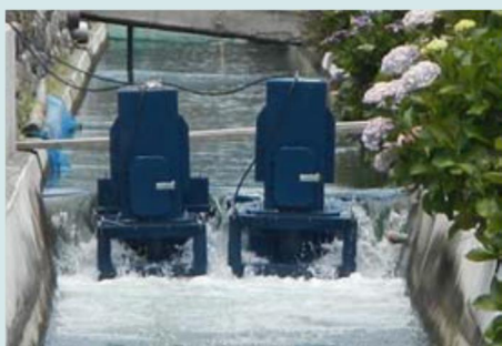
水路に設置した小水力発電
