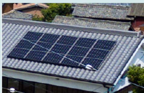
事務所屋根に設置した太陽光パネル
