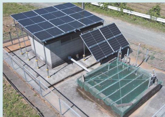
揚水機上に設置された太陽光パネル
