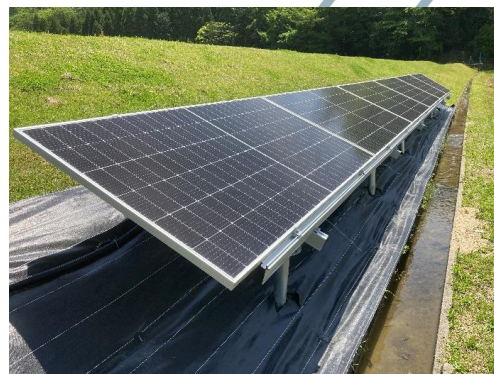
法面の太陽光パネル
