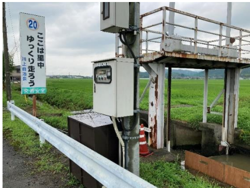
水門（電動）全体
