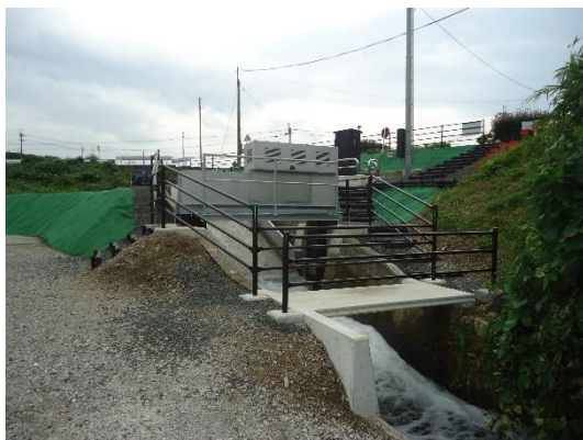
姉川エコ発電所 1 号機 (米原市小田)
