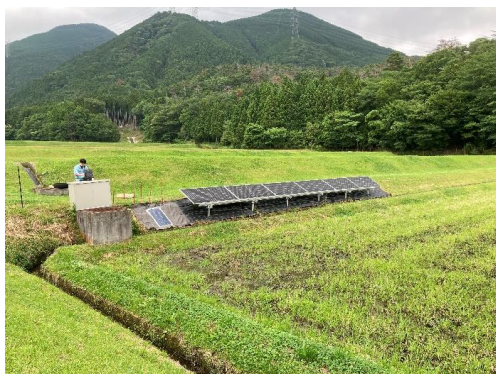
法面の太陽光パネル
