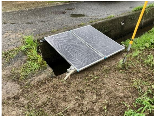
開水路の太陽光パネル
