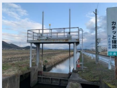
排水路の電動ゲート (竜王町川上)
