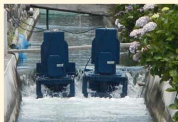
水路に設置された 小水力発電
