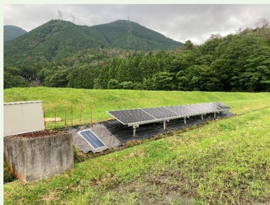
法面に設置された太陽光パネル (日野町西明寺)
