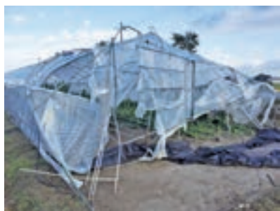
台風によるパイプハウスの倒壊
