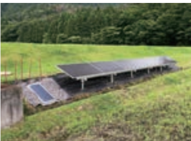
法面への太陽光設置
