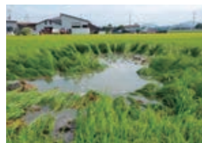
管水路の破損による農地の陥没
