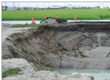
管水路の破損による農地の陥没
