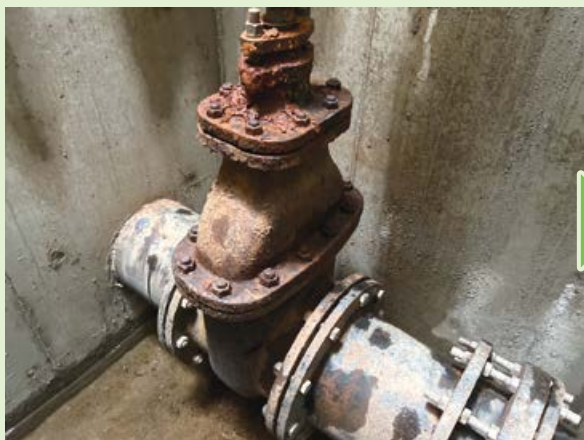
送水設備（更新前）
