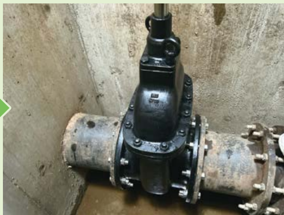
送水設備（更新後）
