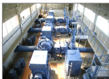
揚水機場(ポンプ施設)
