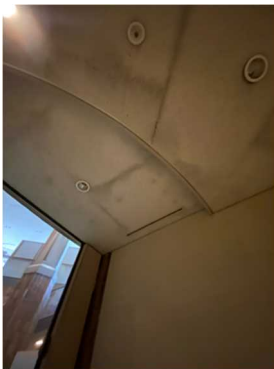
陶芸館地下天井(雨漏り)
