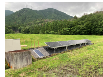
法面などの未利用スペースを活用した太陽光パネル
