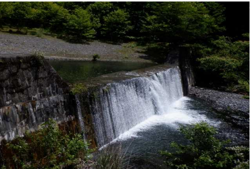
甲賀市土山町黒滝(堤体全体にひび割れ、天端部の欠損)
