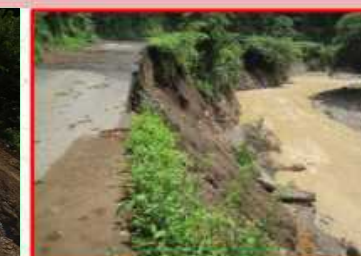
No.56 路肩欠損
