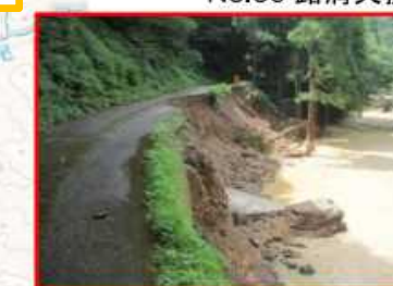
No.54 路肩欠損
