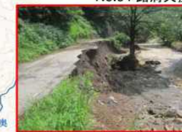
No.49 路肩欠損
