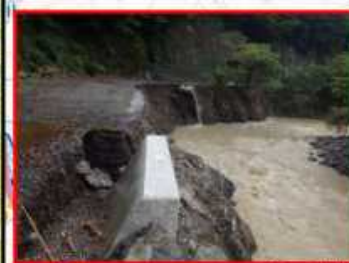
No.21 路肩欠損
