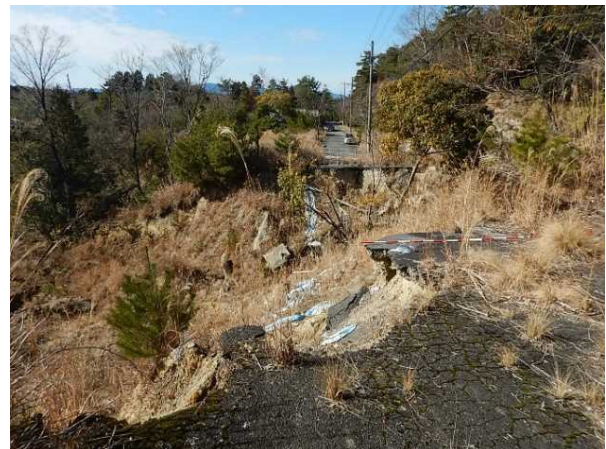
応急対策必要箇所現況写真（日野町）
