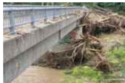
写真 橋梁を覆う倒木 (高時川)
