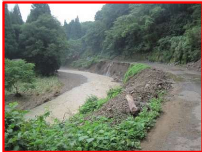
No.81 路肩欠損
