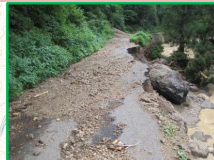
No.60・62 路肩欠損
