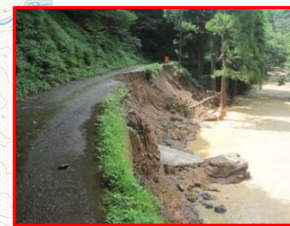
No.54 路肩欠損
