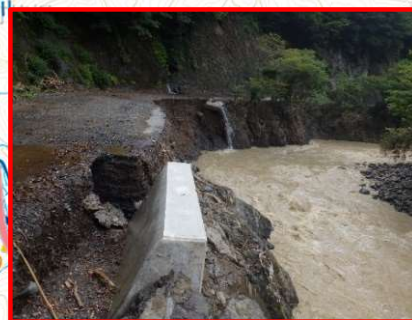
No.21 路肩欠損
