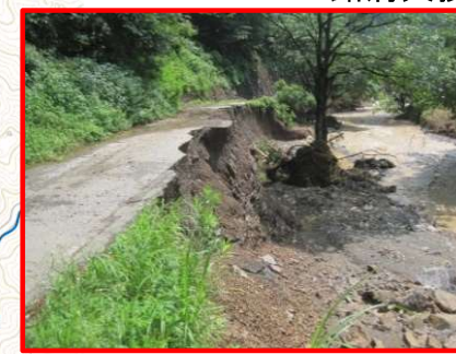
No.49 路肩欠損
