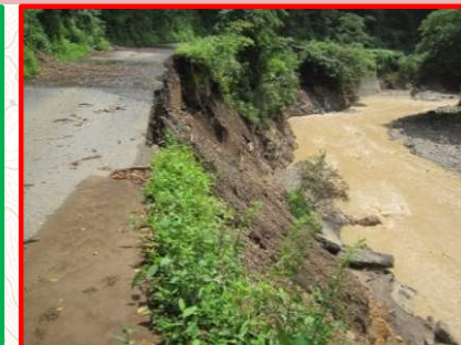
No.56 路肩欠損
