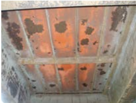
橋梁の損傷状況（防食機能の劣化）
