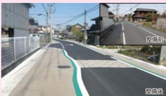
大津能登川長浜線（守山市） 道路を一方通行にして、歩行空間を広げました。
