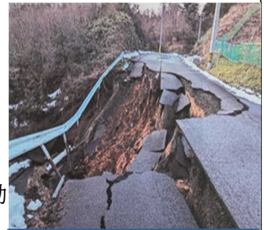
能登半島地震道路被災状況
