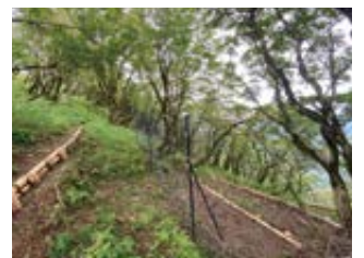
▲獣害防止柵と土壌流出防止施設
