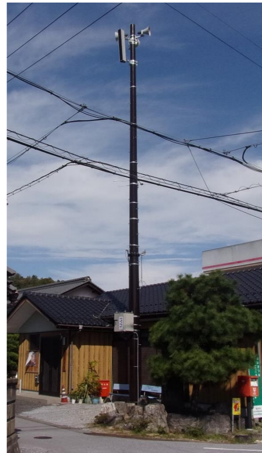
同報系屋外放送設備 写真
