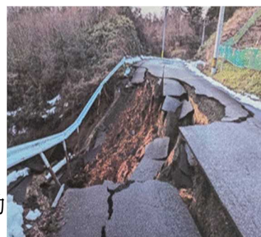
能登半島地震道路被災状況
