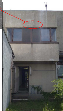
本館外壁の崩落
