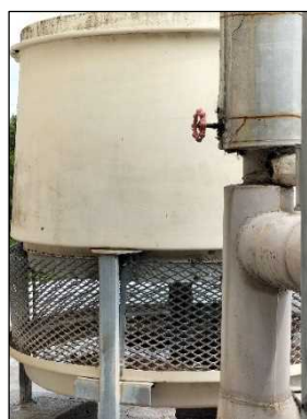
冷房装置故障
