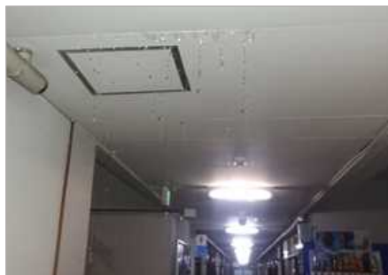
天井からの漏水
