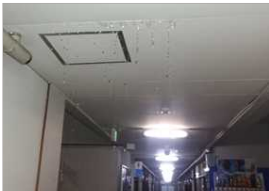
天井からの漏水 (R5)
