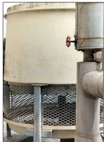
冷房装置故障 (R3)
