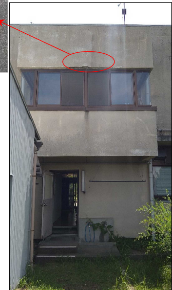
本館外壁の崩落 (R4) 5
