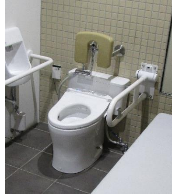
パウチ・しびん洗浄水栓付背もたれ
