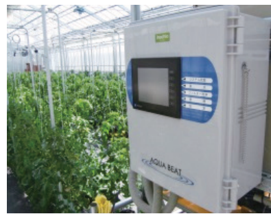
園芸施設内の温度・湿度・二酸化炭素等の環境を制御する装置
