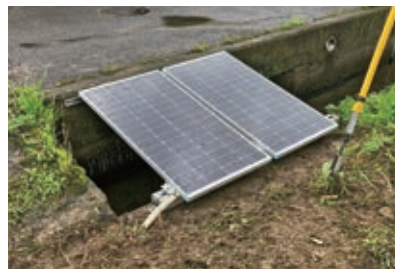
水路上部を活用した太陽光設置
