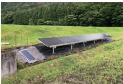
田んぼ法面への太陽光設置
