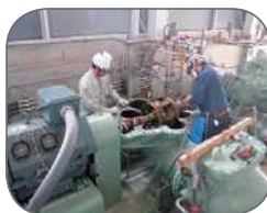
ポンプの点検
