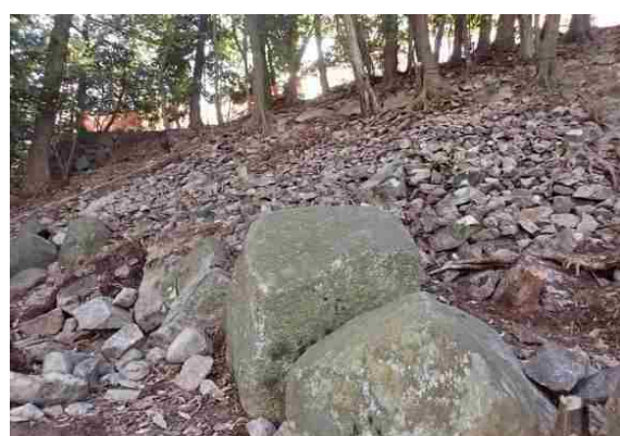
天主台東面の崩落状況（北東から）
