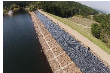
ため池法面での太陽光発電の設置
