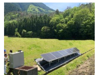
法面を活用した農村地域での再生可能エネルギー地産地消の取組(日野町西明寺)
