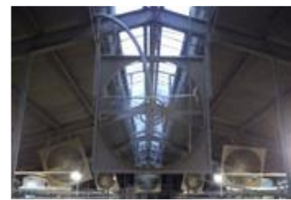
大型扇風機の設置
