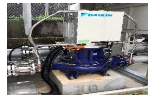
管水路用マイクロ水力発電システム(近江八幡市長福寺町)
