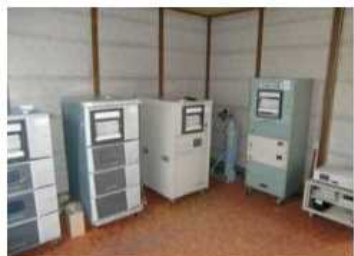
大気自動測定局の内部
