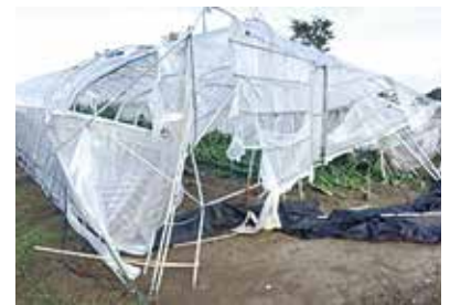
台風被害を受けたハウス
