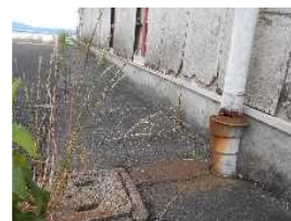
外壁パネルの破損
