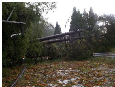
風倒木による被害(大津市)
