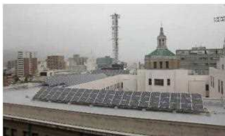
▲ 県本庁舎における太陽光発電設備
