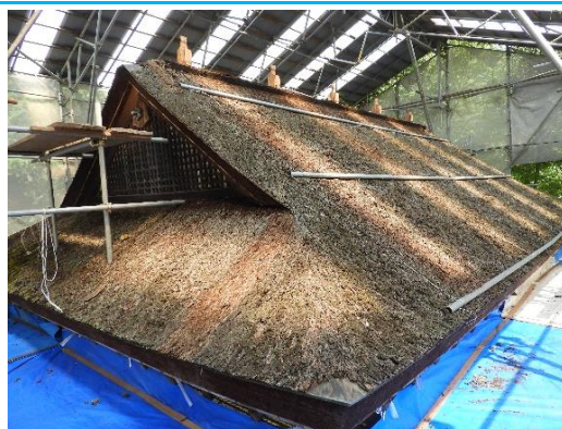
修理前の状況
