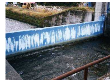
余呉川導水路洪水調節ゲート
