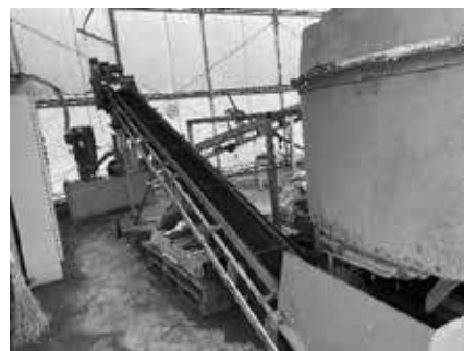
写真1 ペレット堆肥製造ライン
