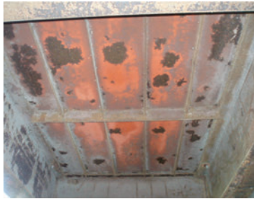
橋梁の損傷状況（防食機能の劣化）
