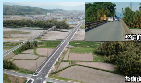
五番領安井川線（高島市） すれ違いが難しい橋を架け替えて、走行しやすい道路を整備しました。
