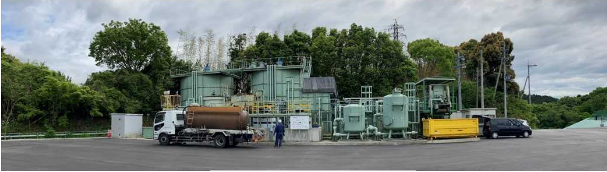
水処理施設の管理状況
