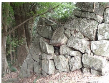
図 7-7 解体修理必要石垣 (摠見寺跡)
