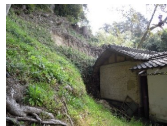
図 7-12 崩壊の状況（惣見寺土蔵裏）
