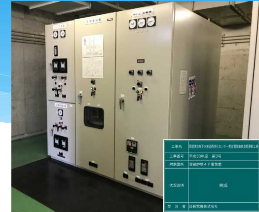
受変電設備 更新
